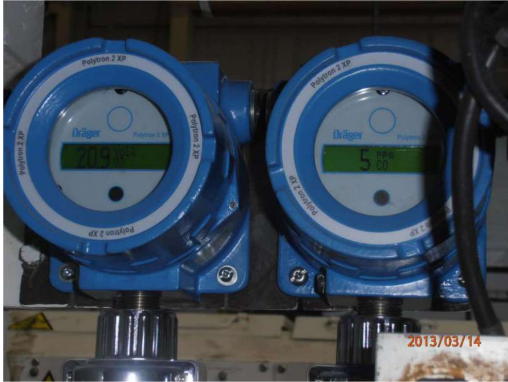
Şekil 15: Gaz ölçüm sistemleri
