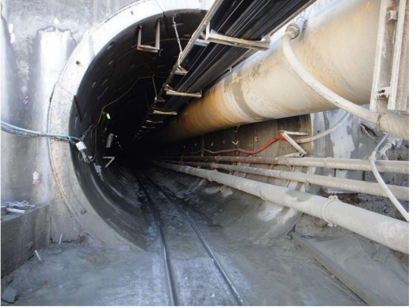
Şekil 33: Bir TBM tüneline havalandıran fantüp sistemi
